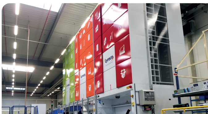
Ενσωμάτωση συστημάτων πυροπροστασίας
